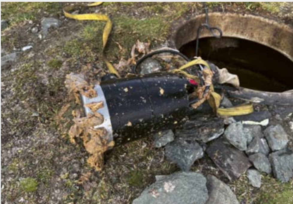
Altschlamm mit diversen Fundstücken, die die Pumpe lahmlegten
