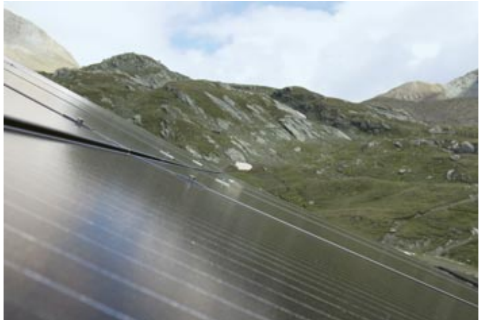
Sonnenkrafttankstelle mit Bergpanorama
